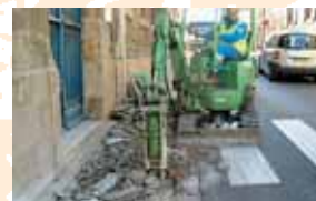
CENTRE-VILLE. AMÉNAGEMENT POUR FACILITER LE DÉPLACEMENT DES PERSONNES À MOBILITÉ RÉDUITE.
